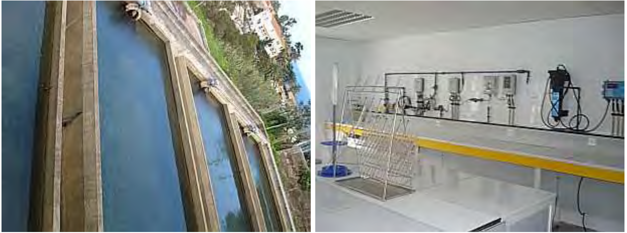
Filtros de arena y Laboratorio de control de la ETAP. Fuente propia.
