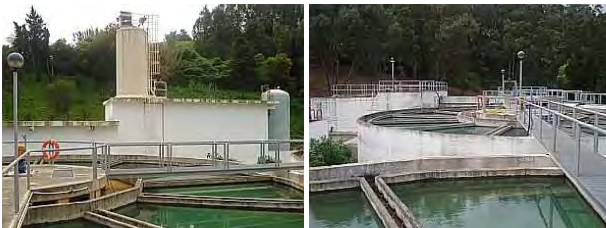
Floculadores-Decantadores de la ETAP. Fuente propia.
